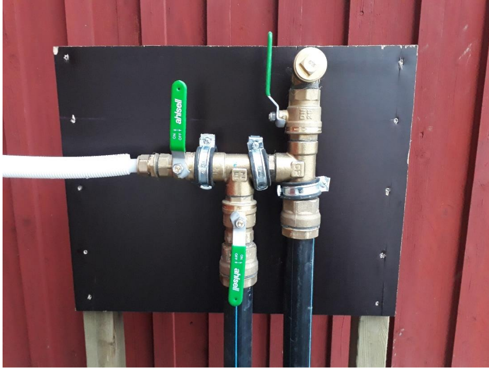
Kuva 2. Pirtin venttiilit tyhjennyksen aikana. Tulppa tulee olla irrotettuna.
